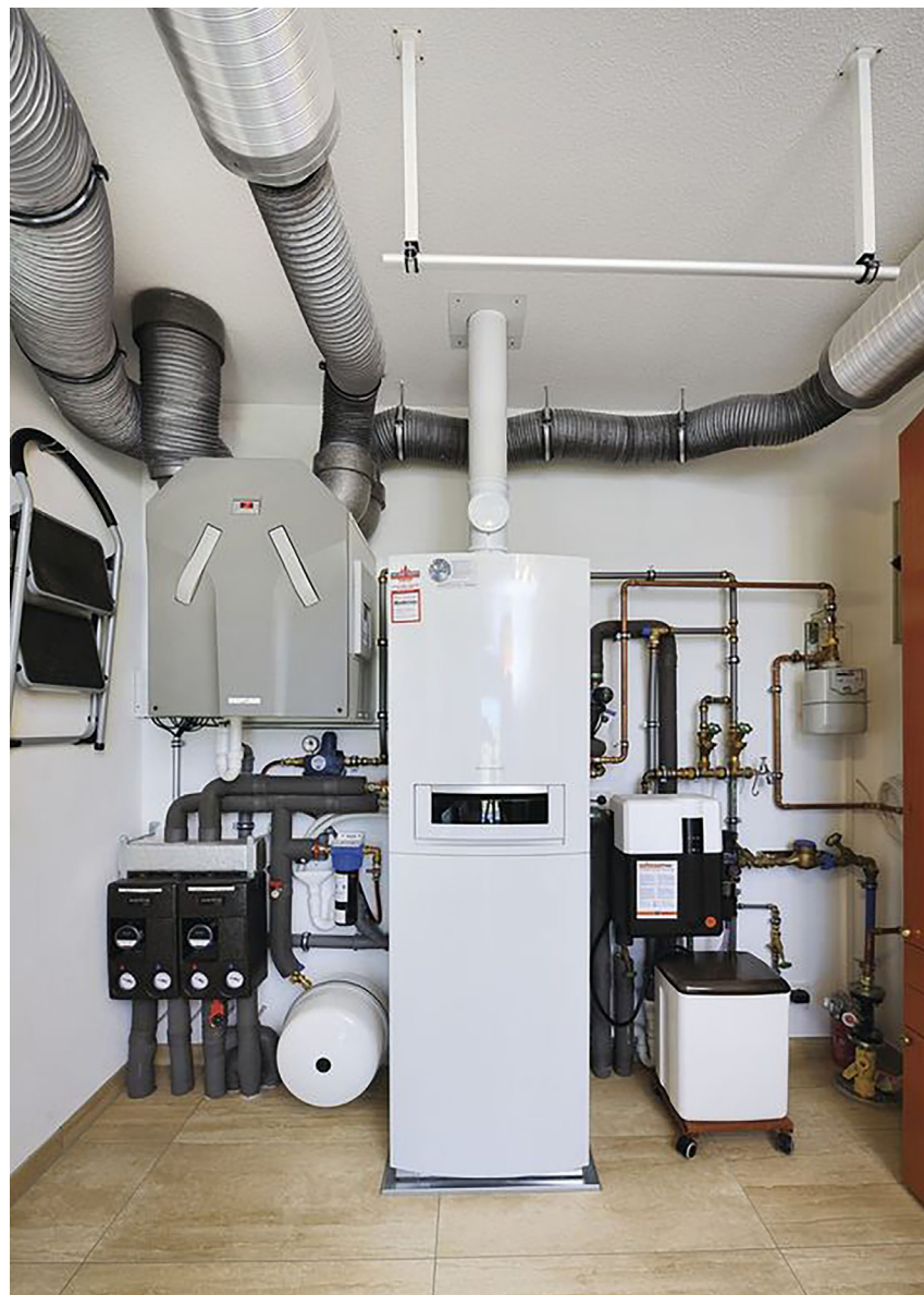
Abb. 1. Technikraum inklusive Heizungs- und Lüftungsanlage, Therme sowie Pumpe für die Fußbodenheizung. Quelle: HausbauDirekt.
