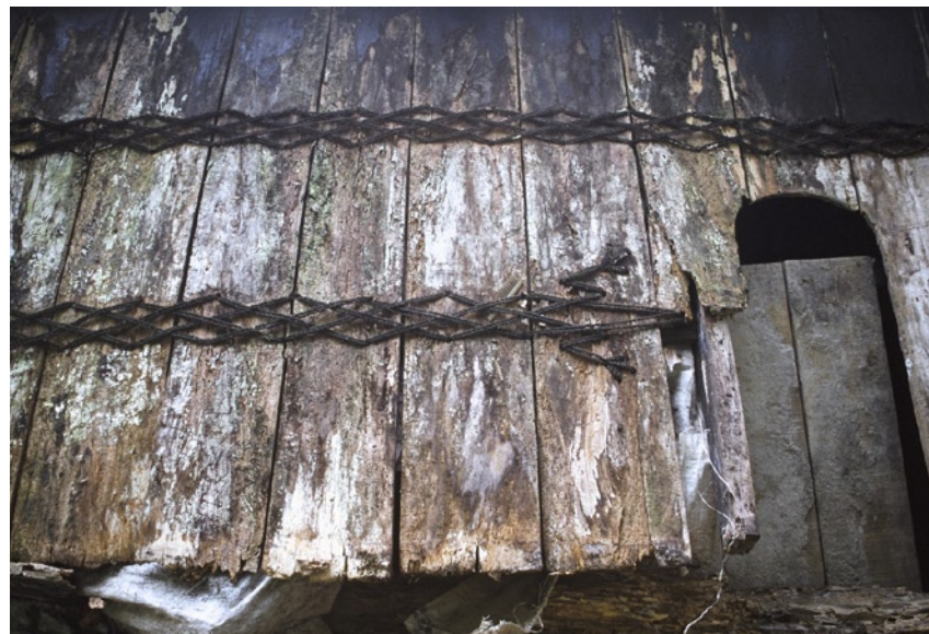
Abb. 4. Konstruktive Details der Wandzone als Dekor: Plankenverschnürungen in Form von Eidechsen an einem Wohnhaus der Karo-Batak. (Peceren)
