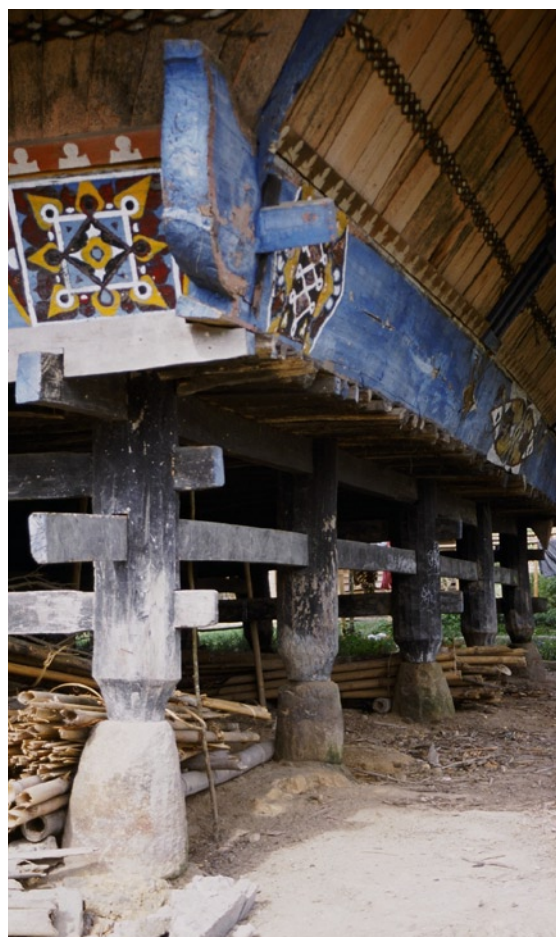
Abb. 3. Die Skelettkonstruktion des Unterbaus eines Wohnhauses der Karo-Batak mit den deutlich zur Schau gestellten bautechnischen Details der Schlitz-Zapfenverbindungen und der Basissteine, die das Verrotten der Steher verhindern sollen. (Lingga)
